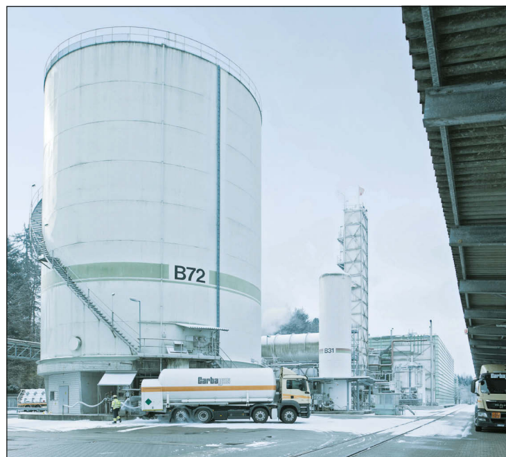
Stickstofftank Carbagas in Utzenstorf BE.
