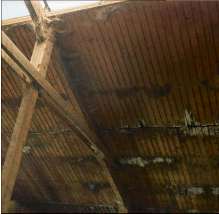
Schimmelbildung und Staubansammlungen unter dem Stalldach lassen auf schlechte Luftqualität im Stallinnern schliessen.
